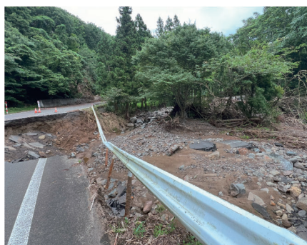
崩れ落ちた秋田県道 285 号 冬師西目線
